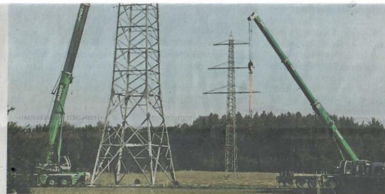
Selbst der Spezialkran braucht noch eine Verlängerung, um die Spitze der Masten auf rund 60 Meter Höhe einzuhängen. In der Landschaft fallen die neuen Masten deutlich stärker auf, als ihre Vorgänger (kleines Bild, oben). Die 110-kV-Leitung muss noch zurückgebaut werden (Mitte). Die Zahl der Masten wurde reduziert, weil sie nun längere Abschnitte überspannen (unten).
