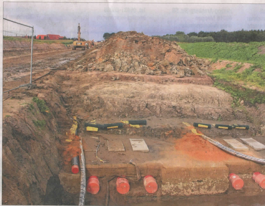
Die Pilotstrecke für Erdkabel in Borken Raesfeld hat die Bürgerinitiative Wellingholzhausen besichtigt.
